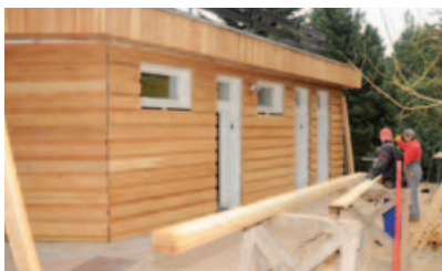
Celá budova u vyhlídkové věže byla obložena kvalitním dřevem /The whole building near the lookout tower was panelled with quality wood/
