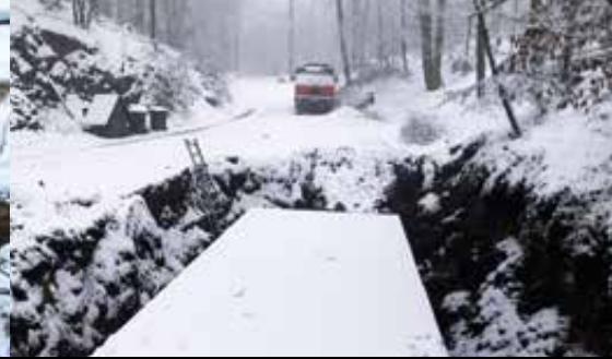
Zadržovací nádrž na vodu /The retention basin/
