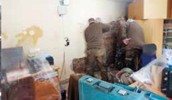
Opravy omítek v kanceláři zoolóšku /The repair of the plastering in the office of the zoo section/
