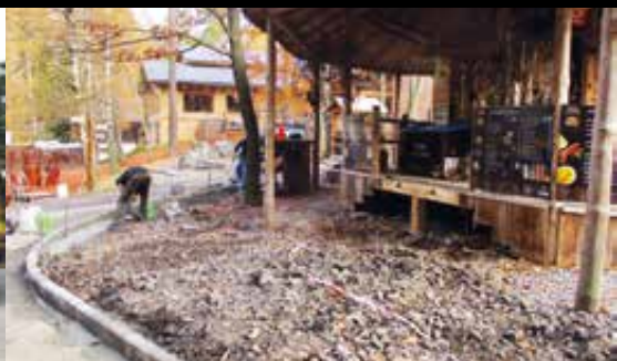
Oprava dlažby u bistra U Lemurů /The reconstruction of the paving at the bistro U Lemurů/
